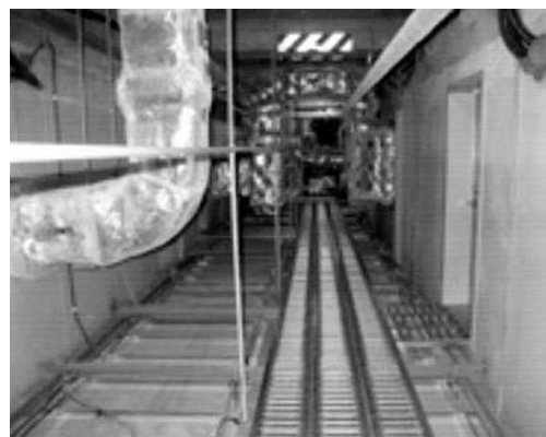
(2) 天井階メンテナンススペース
